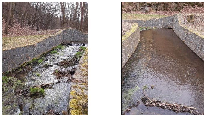
Obr. 32, 33: Protipovodňová ochrana (zdroj: J. Žílová, 2023)
