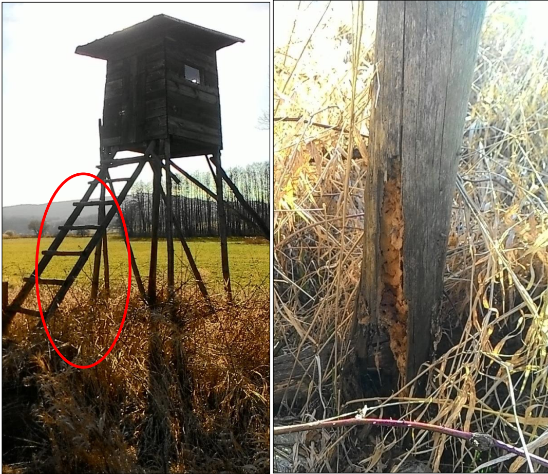
Obrázek 10: Poškozená kazatelna - skryté poškození stojiny (autor)
