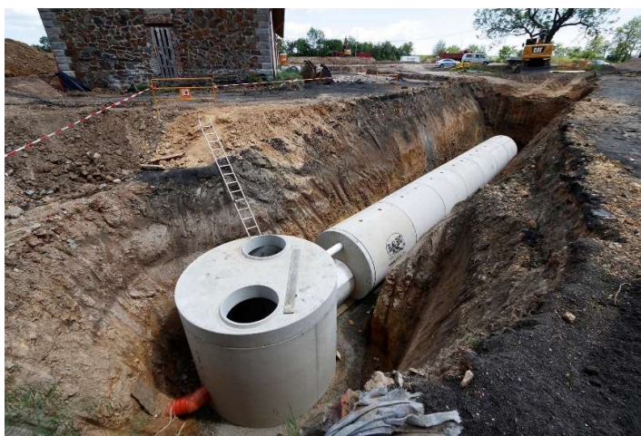
Obr. 6 Trubní retenční nádrž
