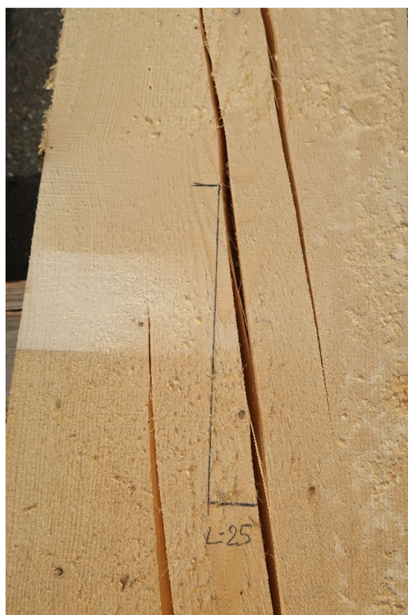
Obrázek 4.15 – měření odklonu vláken ze vztahu výsušné trhliny a čáry označující osu trámu
