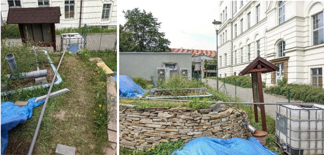
Obrázek 22 - Odtokové potrubí z vertikálního filtru do akumulční nádrže (vlevo: pohled od filtru k nádrži, vpravo: boční pohled)
