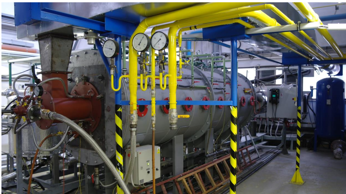
Obr. 11.1 – Zkušebna hořáků na VUT v Brně
