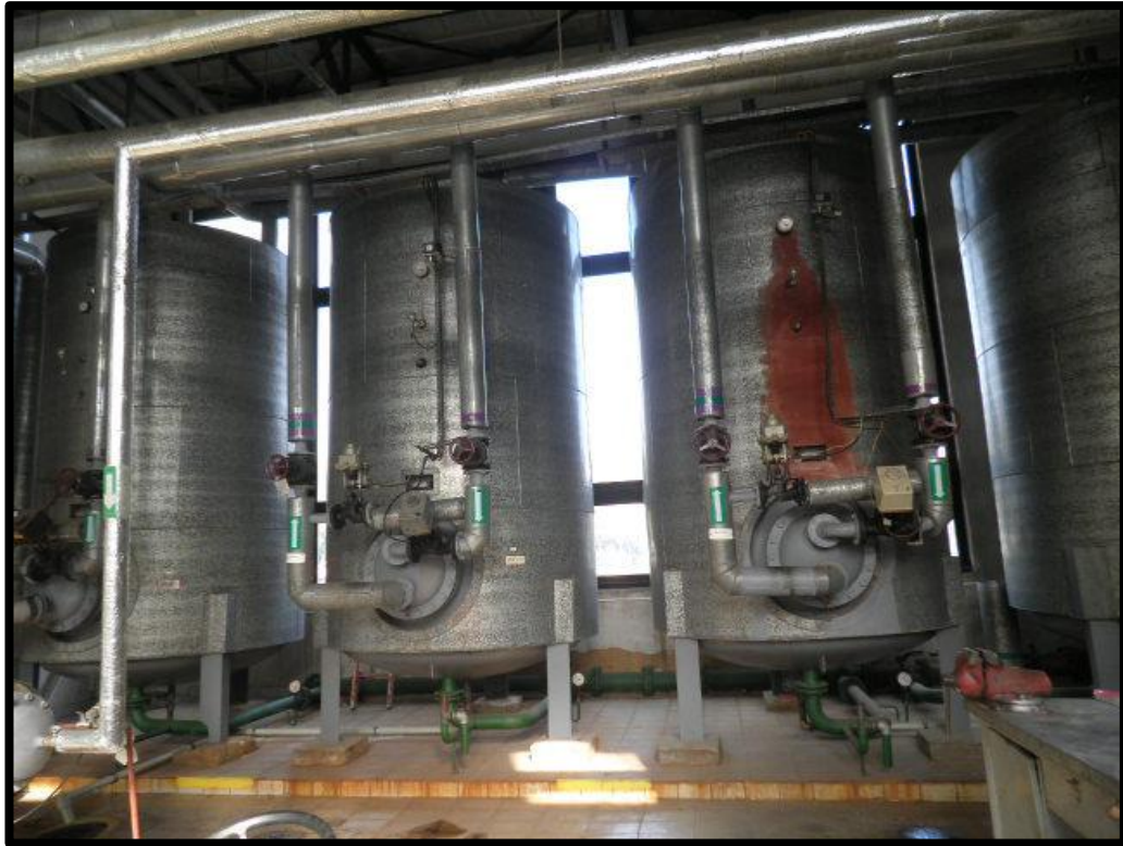
OBRÁZEK Č. 9 – AKUMULAČNÍ ZÁSObNÍKY NA TUV (BAZÉN SLOVANY)
