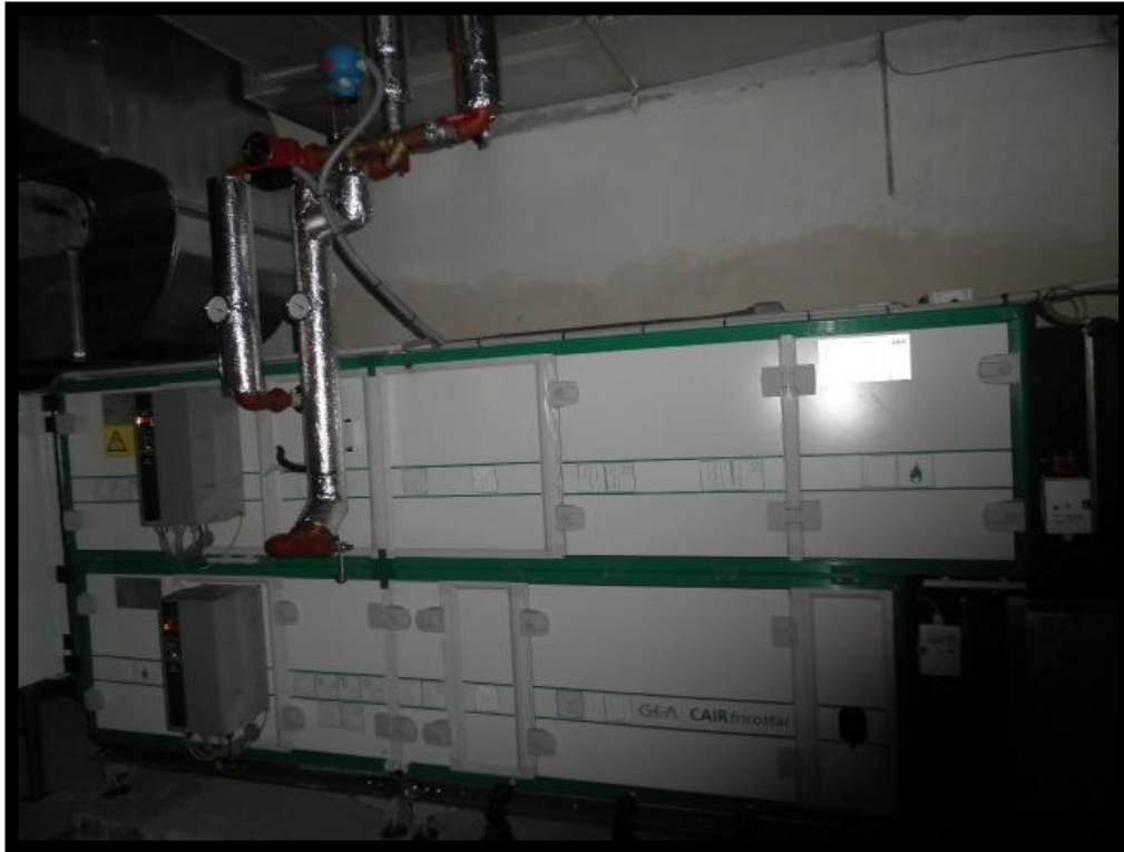
OBRÁZEK Č. 10 – VZDUCHOVÁ JEDNOTKA S REKUPERACÍ (ŠATNY BAZÉNU SLOVANY)
