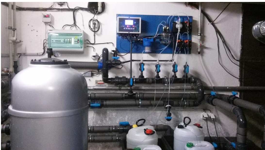
OBRÁZEK Č. 31 – TECHNICKÁ MÍSTNOST S FILTRACÍ O ROZMĚRECH 4 X 2 X 2 METRY
