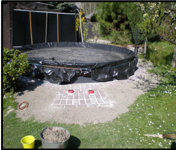
OBRÁZEK Č. 3 – POLOZAPUŠTĚNÝ VENKOVNÍ ZAHRADNÍ BAZÉN SE SOLÁRNÍM OHŘEVEM
