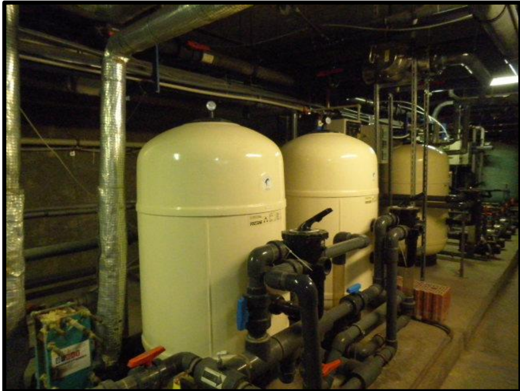
OBRÁZEK Č. 8 – PÍSKOVÁ FILTRACE BAZÉNU SLOVANY
