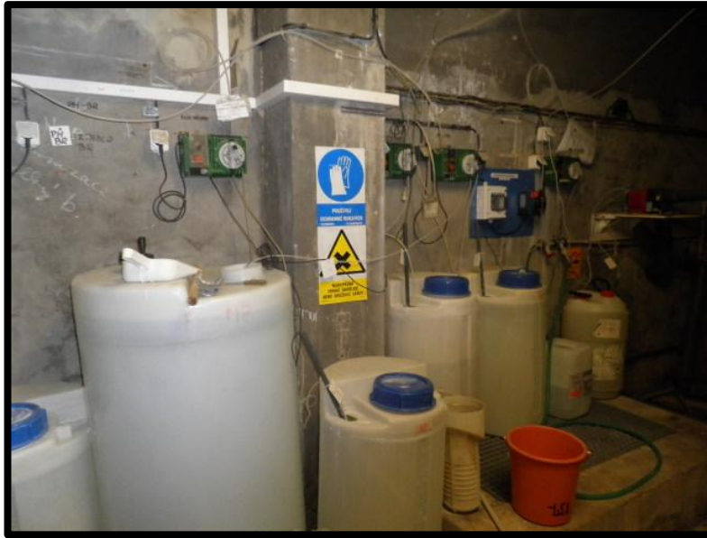
OBRÁZEK Č. 22 – NÁDRŽE CHEMIKÁLIÍ
