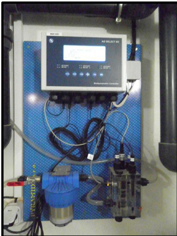
OBRÁZEK Č. 21 – KONTROLNÍ ZAŘÍZENÍ
