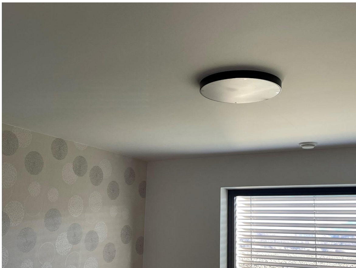
Obr. 20: Fotka rohu obvodových stěn a stropní konstrukce
