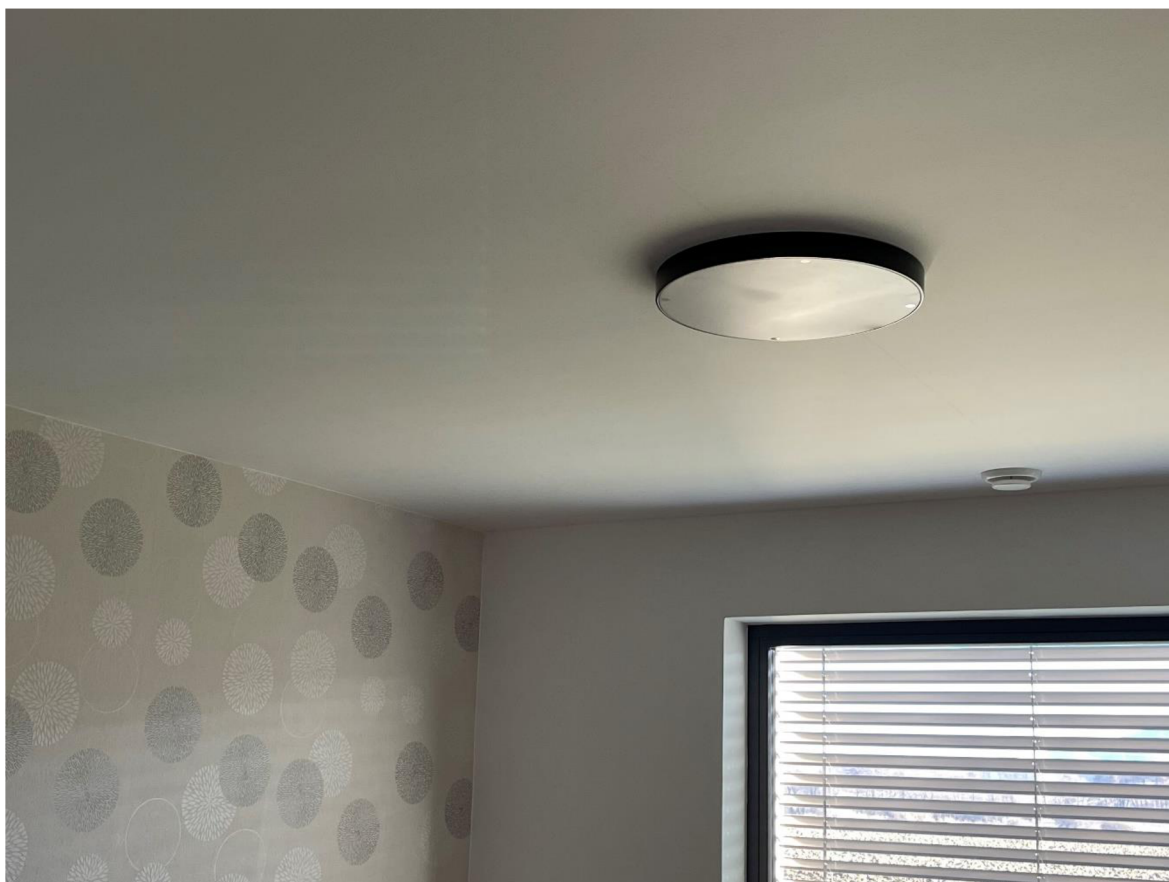
Obr. 20: Fotka rohu obvodových stěn a stropní konstrukce
