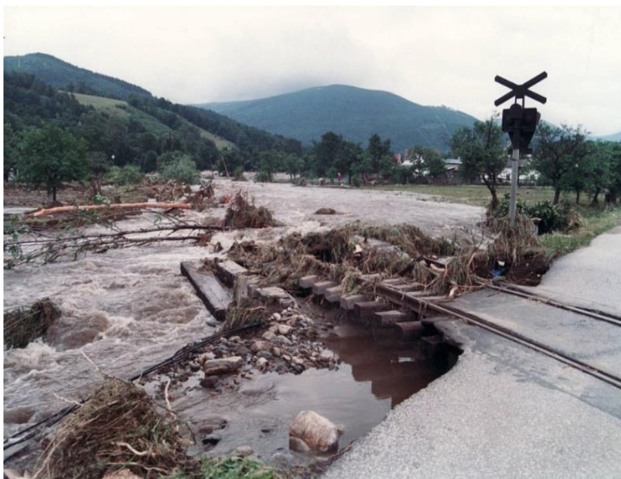
Obr. 1 Zničení železniční tratě v Loučné [10]
