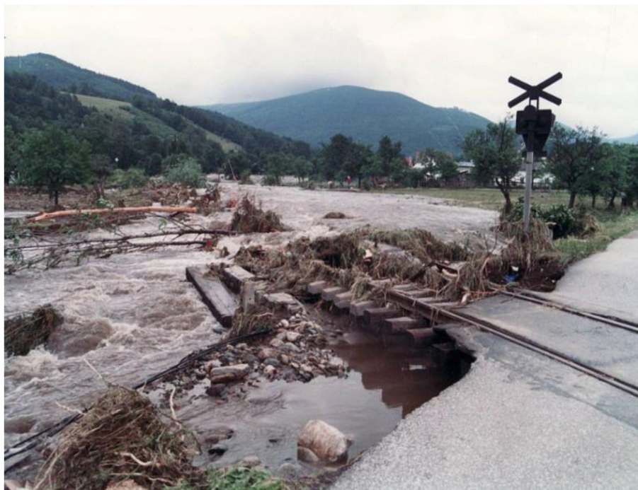
Obr. 1 Zničení železniční tratě v Loučné [10]
