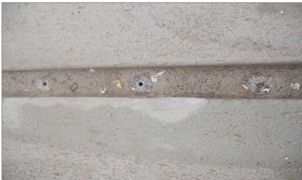
Foto č. 14: Detail drážky s průduchy pro vhánění vzduchu do kompostu (Doležalová, říjen 2011)
