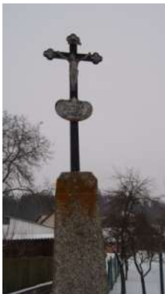
Obrázek 6 Vrstva lišejníku na povrchu stavby
