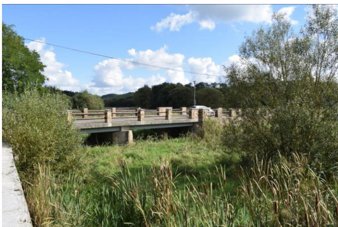
Obr. 11: Detail na bezpečnostní odlehčovací koryto (vlastní fotografie)
