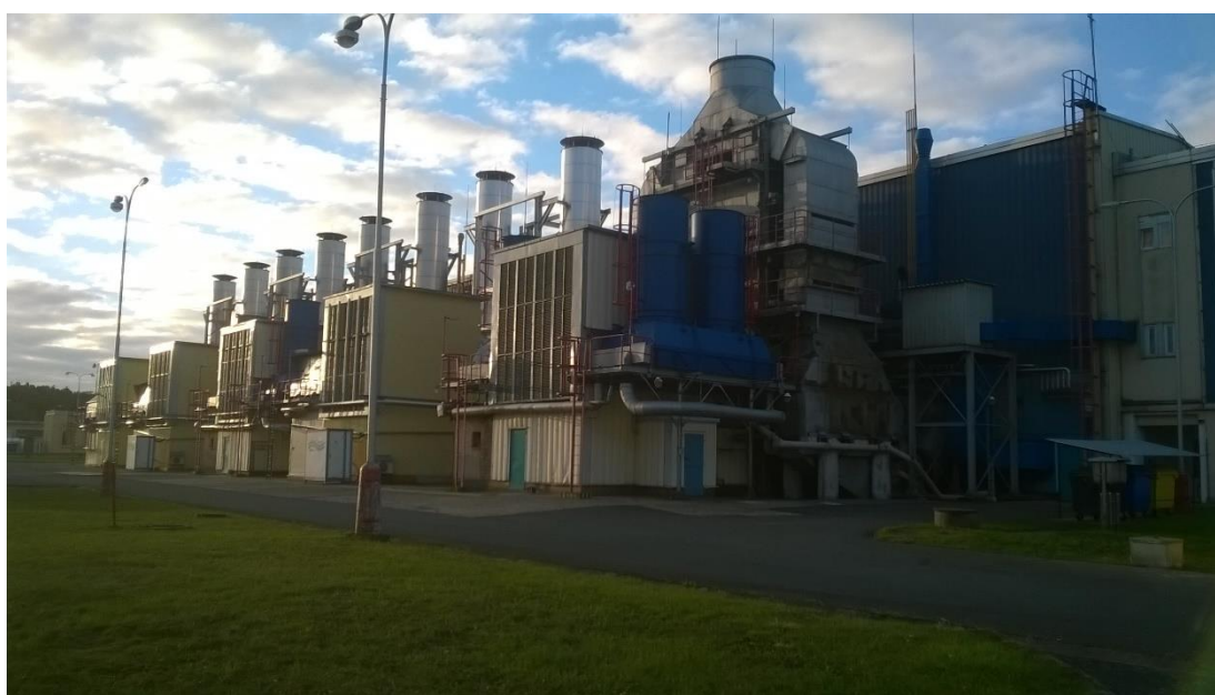
Příloha č. 7 – areál kompresní stanice Kouřim (zdroj: Ladislav Grössl)
