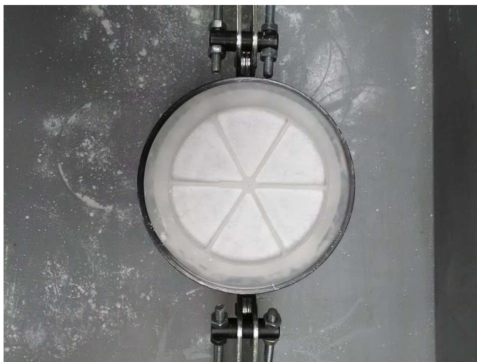
Obr. 35: Filtrační jednotka uložená ve vzduchovém vývodu
