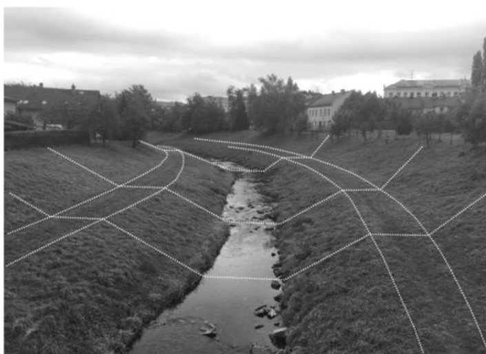
Obr. 5a: Ochranná hráz na Jičínce s typickým lichoběžníkovým profilem (© J. Polášek, říjen 2021; upraveno)
