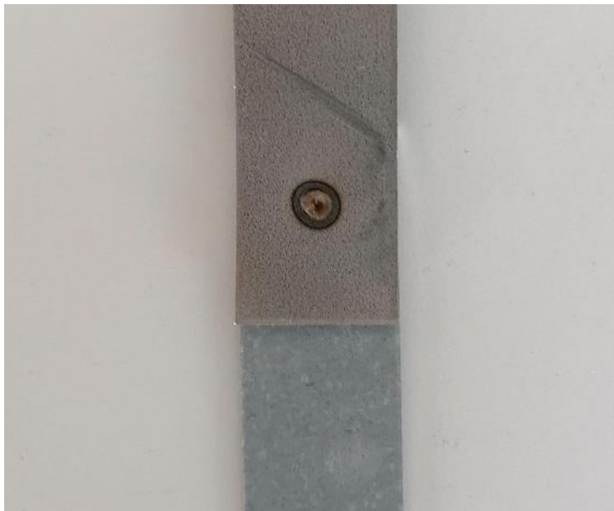
Obr. 28 Neporušený bodový svar
