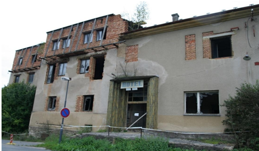
Obr. č. 46 - Pohled na zchátralý bývalý hotel v obci Srbsko
