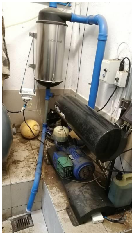
Př. 2 Strojovna DeLaval VMS (Tesař, 2018 (archiv autora))
