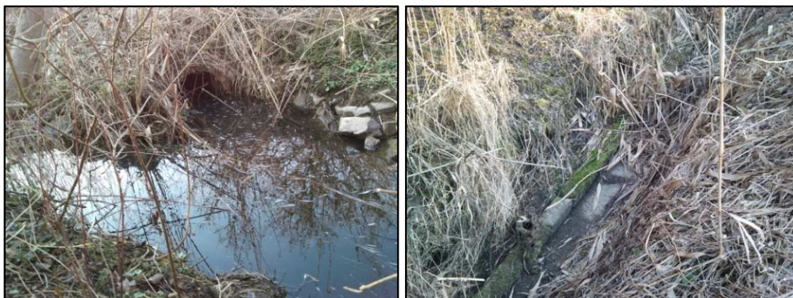
Obr. č. 17 Vyústění potrubí z rybníku, úsek 2 (Jurenka, 2019) Obr. č. 18 Upravenost dna, úsek 2 (Jurenka, 2019)
