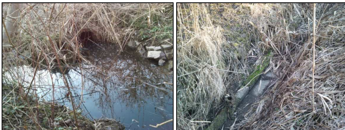
Obr. č. 17 Vyústění potrubí z rybníku, úsek 2 (Jurenka, 2019) Obr. č. 18 Upravenost dna, úsek 2 (Jurenka, 2019)
