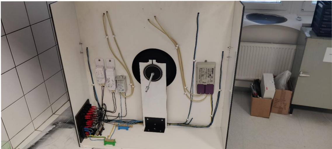
Obr. 31. Zadní část svítidla a elektroinstalací
