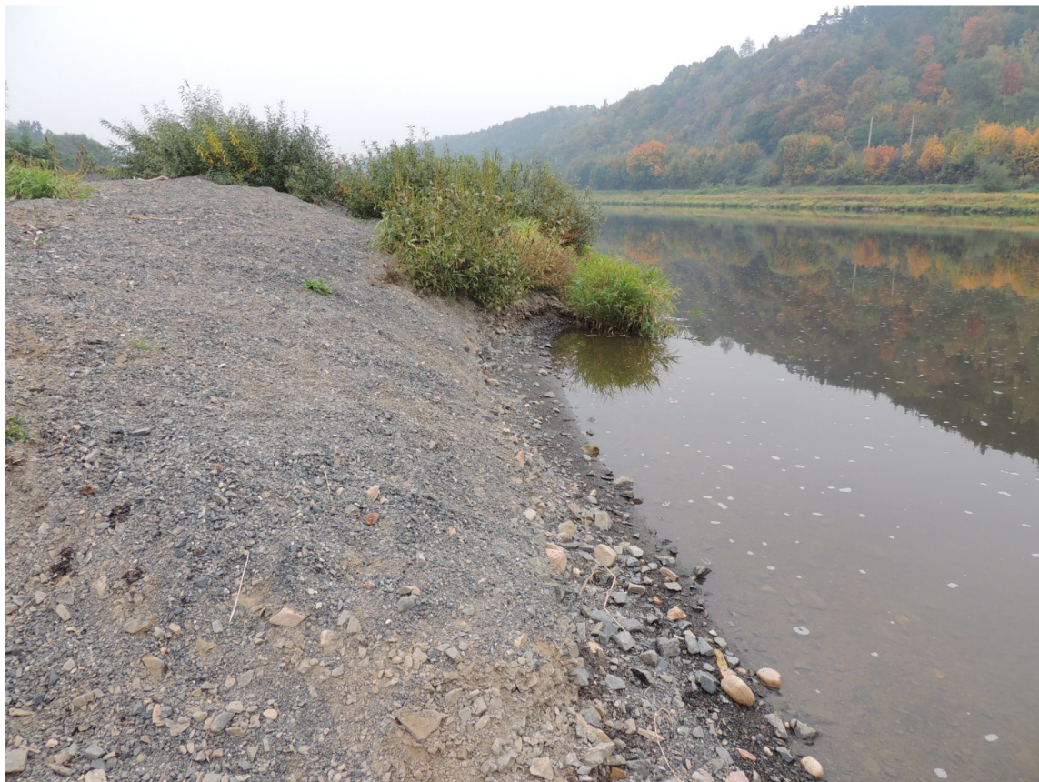
Fotografie č.3: Navážka navezená na vymletý břeh po povodni, cca v místě PF8
