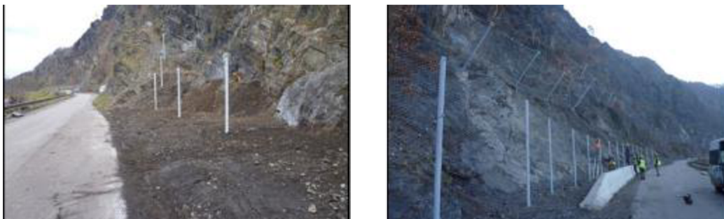
Obrázek 7.7 a 7.8 – Ochranné ploty komunikace u paty skalního svahu SO 03, SO 06
