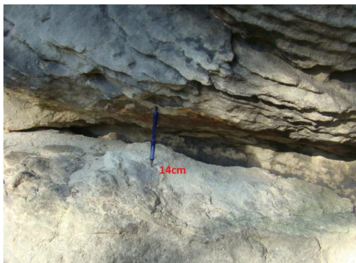
Obr. 50 Puklina na skalním srubu
