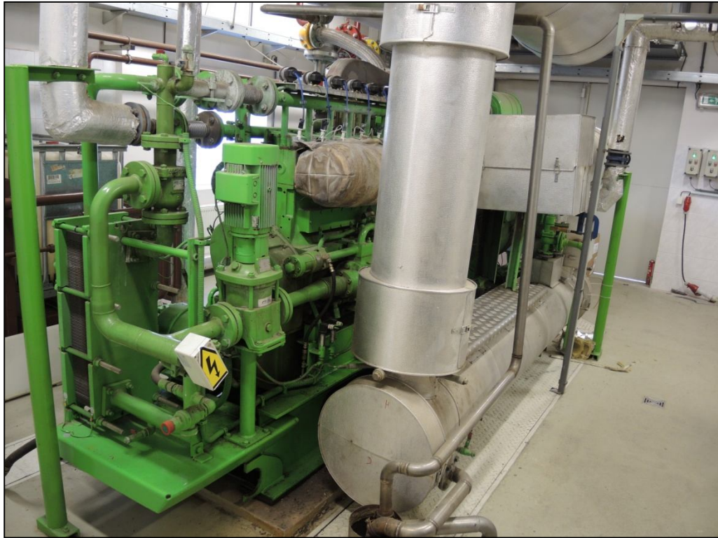
Kogenerační jednotka (foto autora, 2013)
