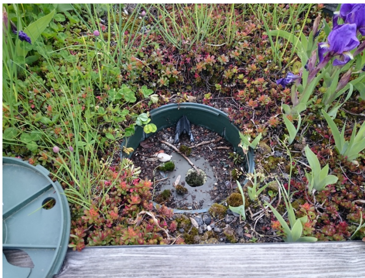
Obrázek č. 2: Demonstrace nevhodně provedeného odtoku (zdroj: autor, 2016)
