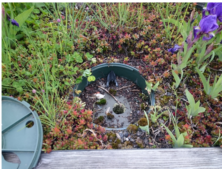
Obrázek č. 2: Demonstrace nevhodně provedeného odtoku (zdroj: autor, 2016)
