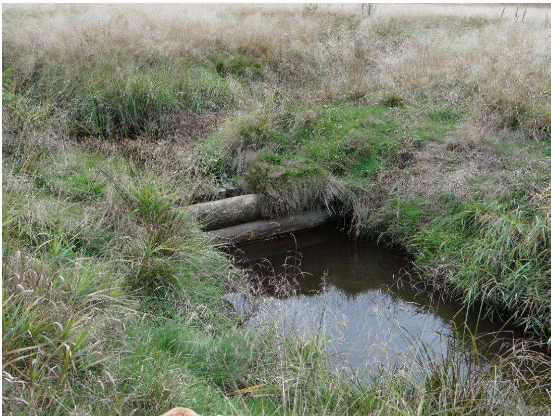
Obr. č. 23, Nefunkčnost přehrážek. Foto: Databáze projektu TB030MZP114.
