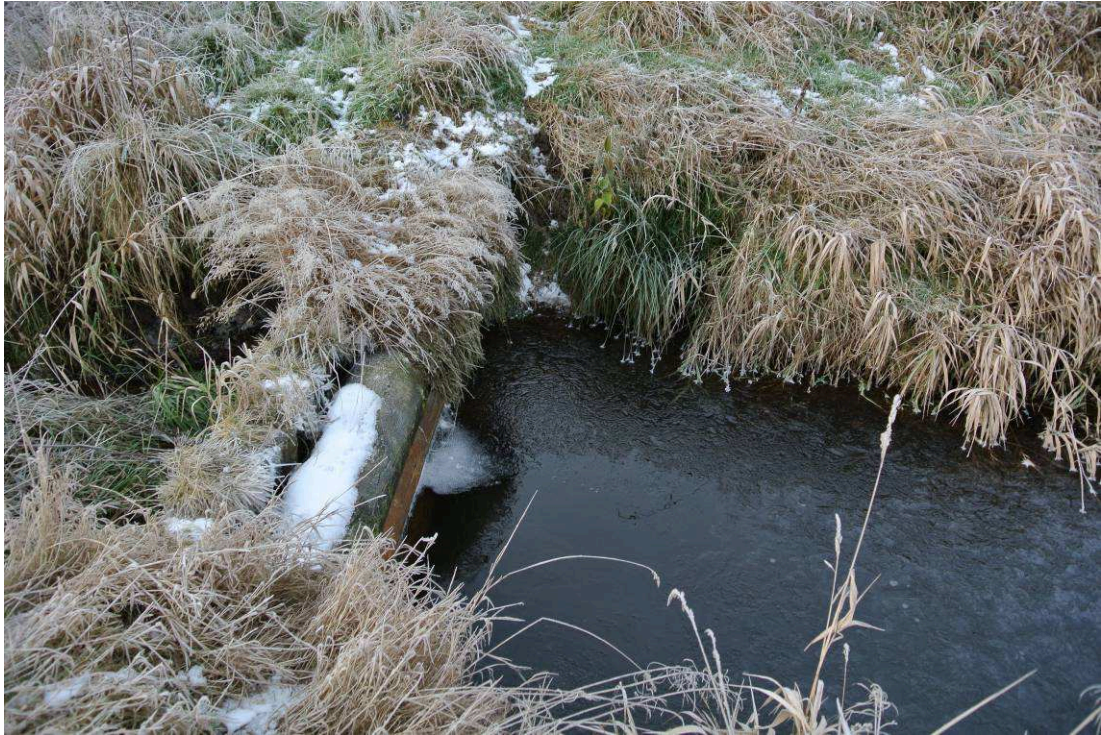
Obr. č. 24, Nefunkčnost přehrážek. Foto: Databáze projektu TB030MZP114.
