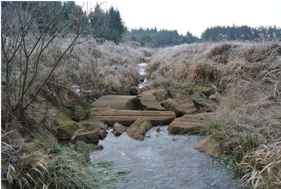
Obr. č. 25, Nefunkční kamenný skluz. Foto: Databáze projektu TB030MZP114.
