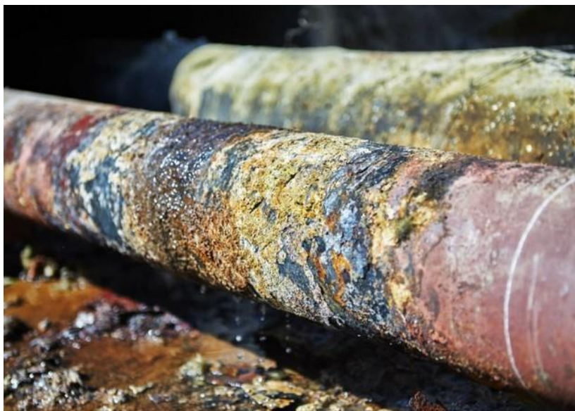
Obrázek 1.2 Poškození potrubí v důsledku bludných proudů [2]
