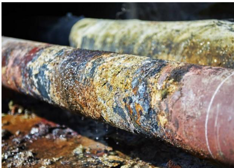
Obrázek 1.2 Poškození potrubí v důsledku bludných proudů [2]
