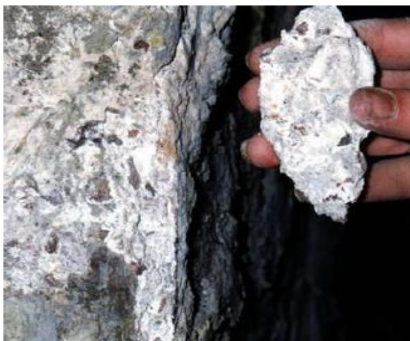
Obr. 5: Degradace konstrukce po dlouhodobém vystavení působení thaumasitu [26]
