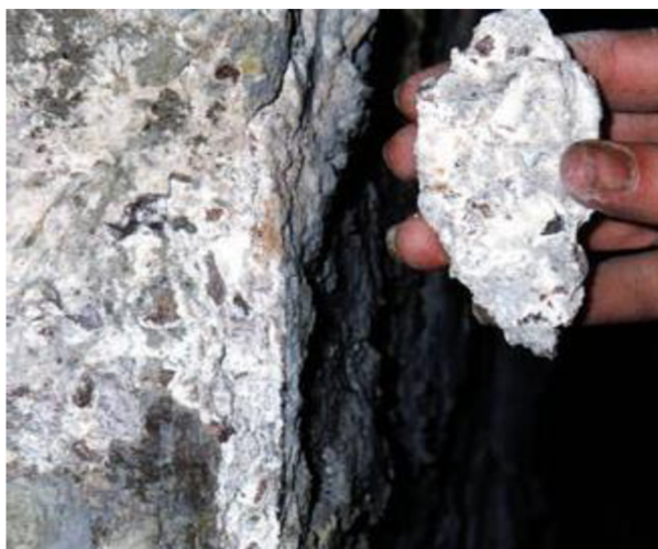
Obr. 5: Degradace konstrukce po dlouhodobém vystavení působení thaumasitu [26]
