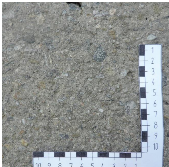
Obr. 38 Detail povrchu CBK vozovky na dálnici D1 (km 246,5 - 246) [4]
