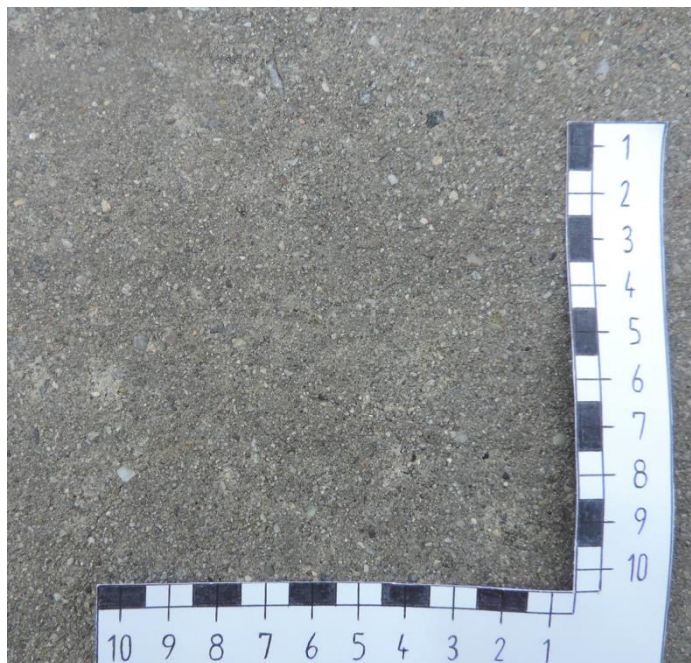
Obr. 41 Detail povrchu CBK vozovky na dálnici D1 ( km 245,7 – 245,5 ) [4]
