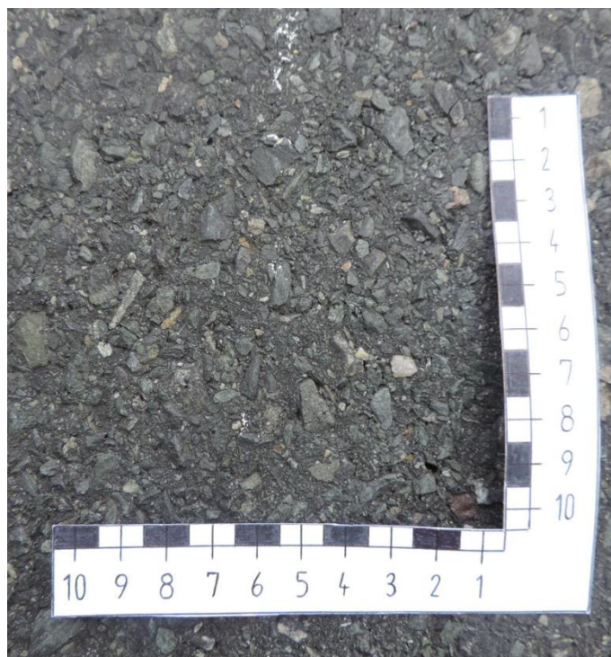
Obr. 40 Detail povrchu asfaltového krytu vozovky na dálnici D1 ( km 245,8 – 245,7 ) [4]
