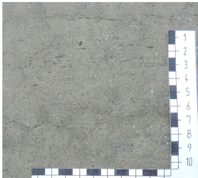
Obr. 39 Detail povrchu CBK vozovky na dálnici D1 ( km 246 – 245,8 ) [4]
