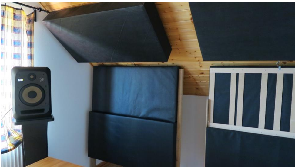
Obr. 3.5 Absorpční prvky na bocích místnosti.
