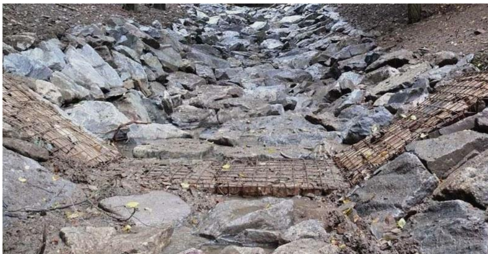
Obr. 18: Ukázka kamenného skluzu se zajišťovacím prahem (Lesy ČR, 2017)
