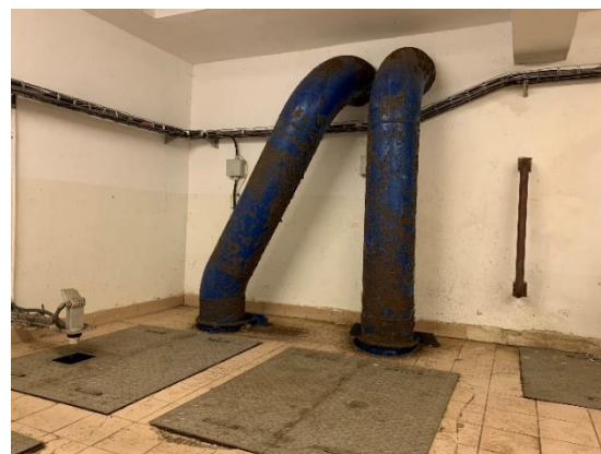
Obr. 31: Čerpací stanice dešťových vod (vlastní foto)
