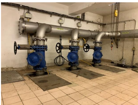
Obr. 30: Čerpací stanice odpadních vod (vlastní foto)
