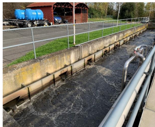
Obr. 43: Nátokový koridor - příčné proudění v MBBR reaktoru (vlastní foto)
