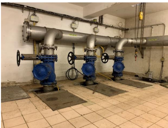
Obr. 30: Čerpací stanice odpadních vod (vlastní foto)
