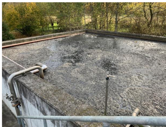
Obr. 36: Kalové silo s přebytečným kalem z DN (vlastní foto)
