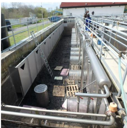
Obr. 40: Pohled na nátokový koridor (PŘ ČOV Tlučná VP, 2022)
