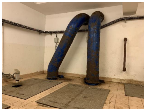
Obr. 31: Čerpací stanice dešťových vod (vlastní foto)
