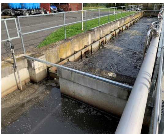
Obr. 42: Pohled na nátok do MBBR reaktoru (vlastní foto)
