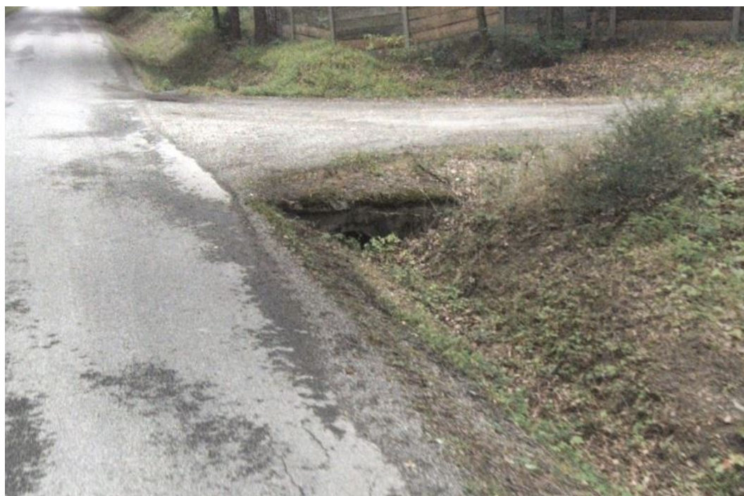
Obrázek 25 Zanesený propustek u obory Louže
