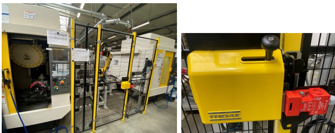
Obr. 23) a) Pohled na ochranné oplocení b) Detail bezpečnostního zámku
