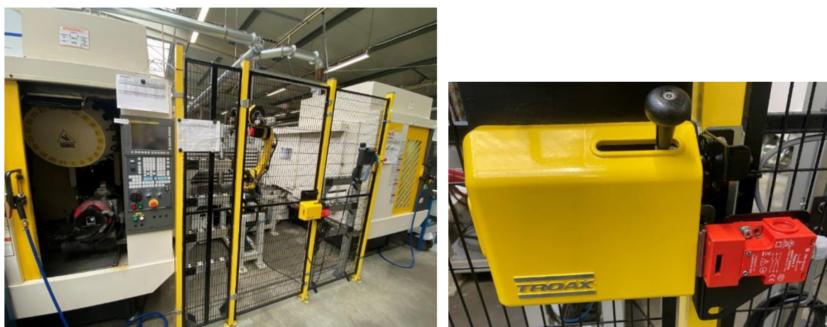
Obr. 23) a) Pohled na ochranné oplocení b) Detail bezpečnostního zámku
