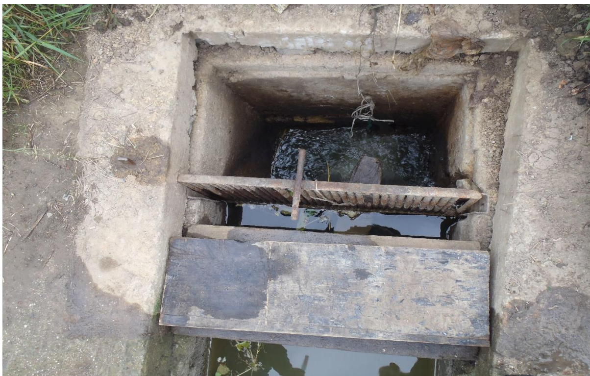
Foto. 5.2 Výpustný objekt nádrže Jandovka
