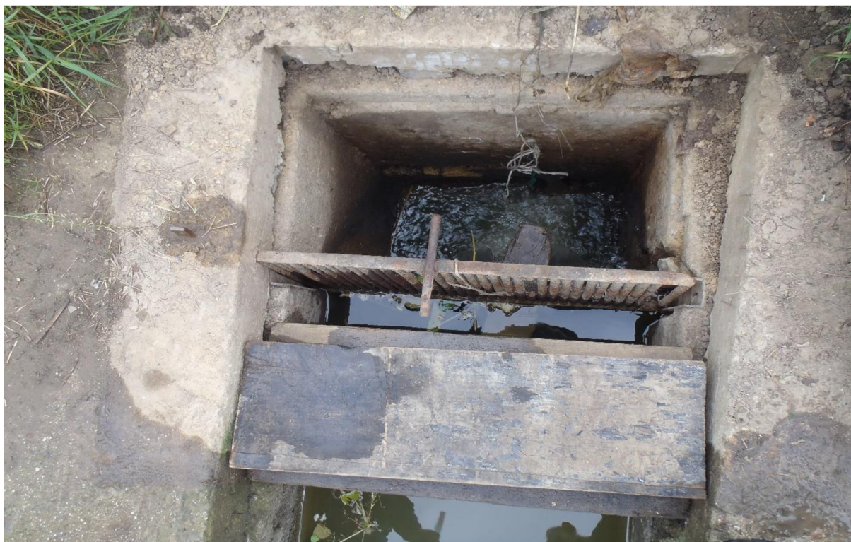
Foto. 5.2 Výpustný objekt nádrže Jandovka
