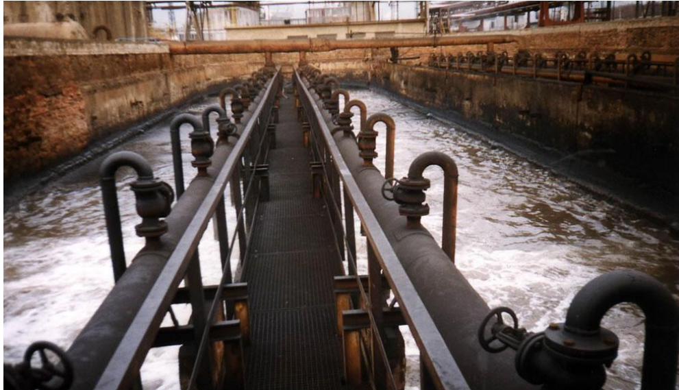
Obr. č. 11 Reakční nádrž II° (Čištění odpadních vod v Chemopetrol, a.s., 2003)
