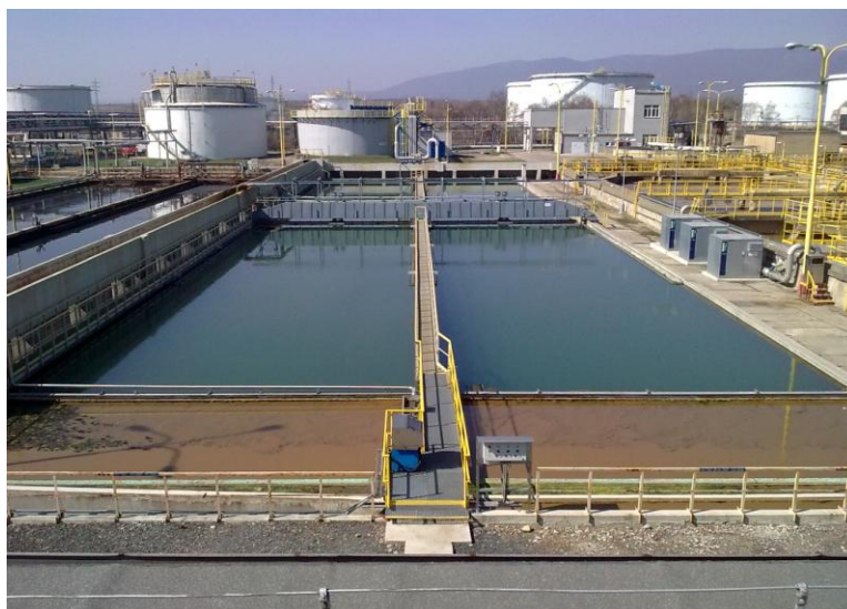
Obr. č. 13 Dosazovací nádrž II (Letalíková ,2010)
