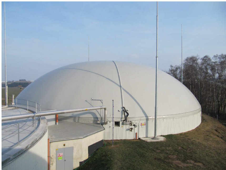
Obrázek č. 15: Dofermentor s integrovaným nízkotlakým zásobníkem plynu
