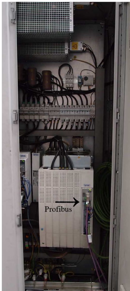
Obr. 14 Rozvádzačová skriňa s frekvenčným meničom pre os manipulátoru
