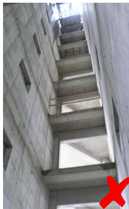
Obrázek č. 151 - Schodiště – špatně [29]
