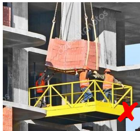
Obrázek č. 169 - Doprava materiálu – špatně [29]
