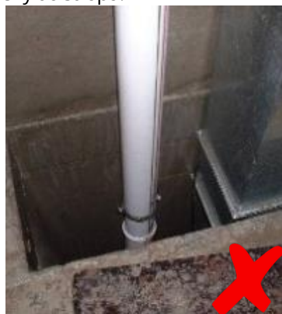
Obrázek č. 159 - Instalace rozvodů – špatně [29]
