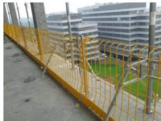
Obrázek č. 177 - Kolektivní ochrana – zábradlí [29]
