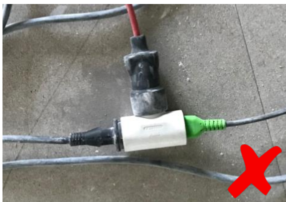
Obrázek č. 139 - Prodlužovací kabely – špatně [29]
