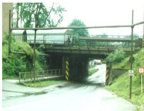
Obr. 8 Silnice II/468 před rekonstrukcí;
