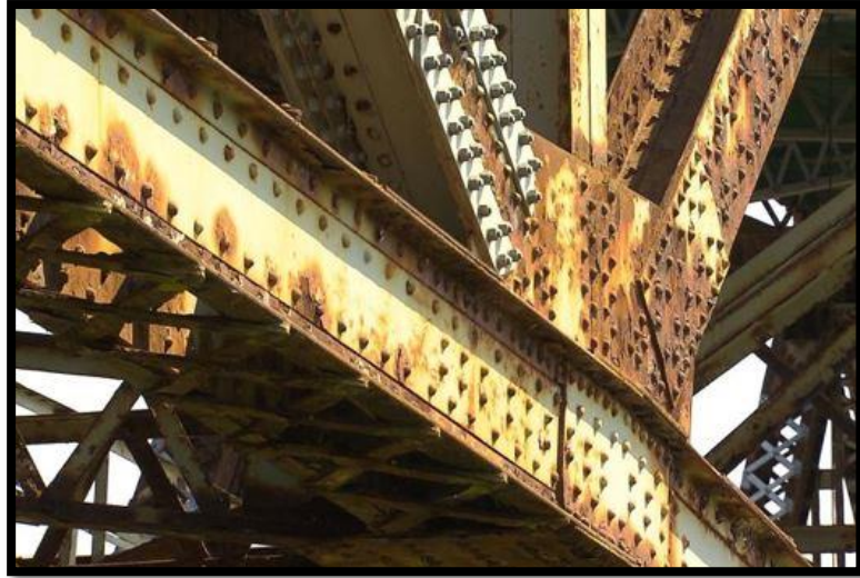
Obr. 11 - Koroze v atmosféře, mostní konstrukce (Zdroj: corrosion and Coatings Expo)
