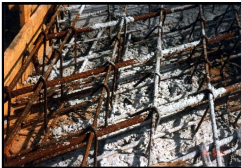
Obr. 14 - Předkorodovaná výztuž použitá při stavbě železobetonového mostu (Zdroj: VŠCHT)
