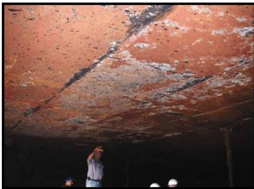
Obr. 13 - Korozní produkt na betonové konstrukci (Zdroj: www.mmspektrum.com )
